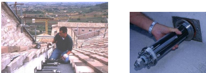
Figura 1-40: Dispositivi SMAD installati nella Basilica di San Francesco d'Assisi(1999)
