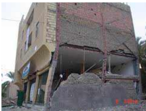
Figura. 3-37: Sistema di controvento non accettabile: insufficiente sezione degli elementi di controvento
